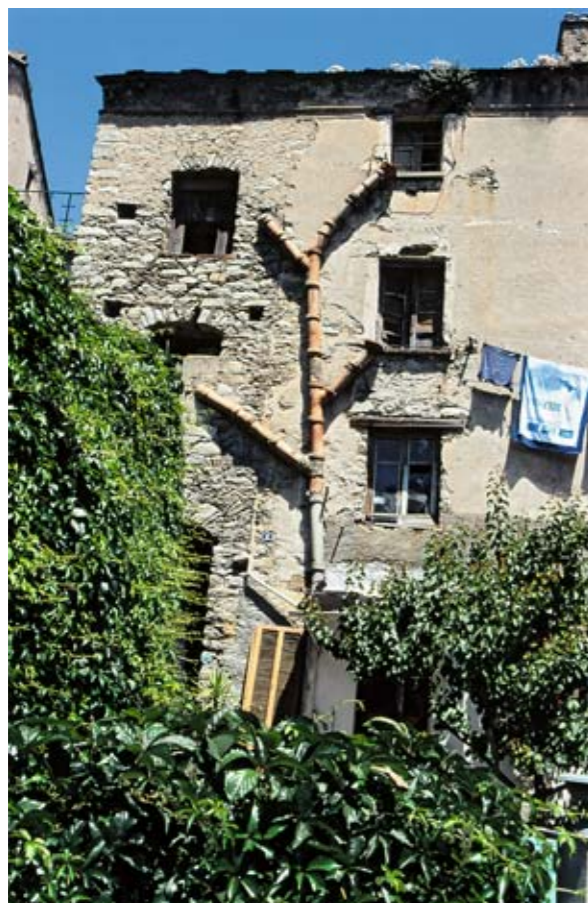
Svrázná, poněkud zastaralá kanalizace.
